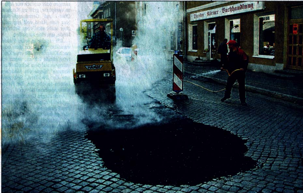
Freie Bahn schafft Dampfwalzenfahrer Bodo Küster von der Baugesellschaft Geidel in der Nauener Mittelstraße. Über den Winter fest geschlossen ist das 32 Meter lange Loch zwischen Kirch- und Lazarettstraße. Damit besteht auch für Hunderte von Kindern keine Gefahr mehr, die sich heute Abend ab 18 Uhr dem Halloween-Umzug von Janny's Eis-Laden anschließen. Von der Ecke Berliner Straße geht es quer durch die Innenstadt zum Lagerfeuer auf dem Sägewerksplatz, hier ist für Imbiss und Getränke gesorgt. Zuvor ab 16 Uhr gibt es in der Käthe-Kollwitz-Grundschule Gruselgeschichten um Halloween zu hören. Ab 16.30 Uhr bekommen Kinder in rund zwei Dutzend mit Kürbissen und Kerzen geschmückten Innenstadtgeschäften „Süßes & Saures“. FOTO: WOLFGANG GERTH
